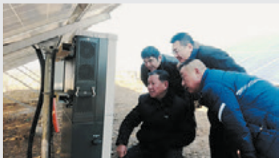
小型光伏电站投入运营
